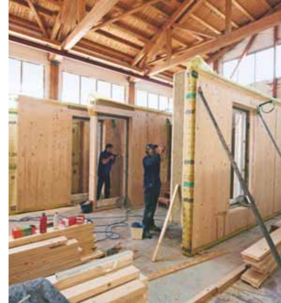
▲ Vorfertigung und Montage übernehmen die Zimmerer der Anton Ambros GmbH aus Hopferau/Allgäu
