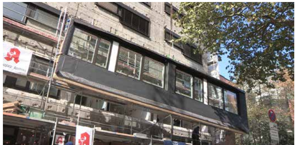
Inklusive Fenster und Dämmung wurden die circa drei mal 13 Meter großen Elemente auf die Baustelle geliefert.
