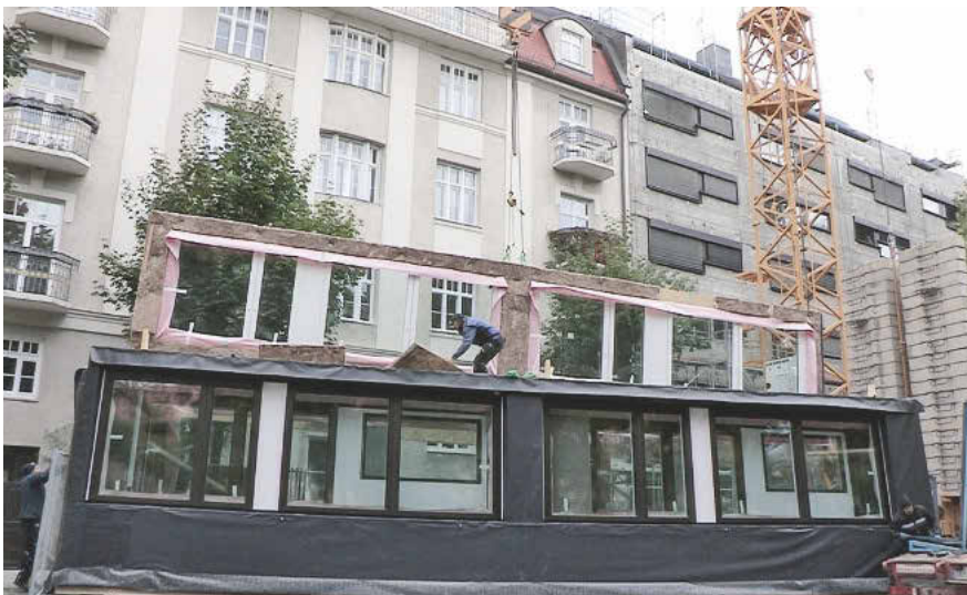
Inklusive Fenster und Dämmung wurden die circa 3 x 13 m Elemente auf die Baustelle geliefert.
