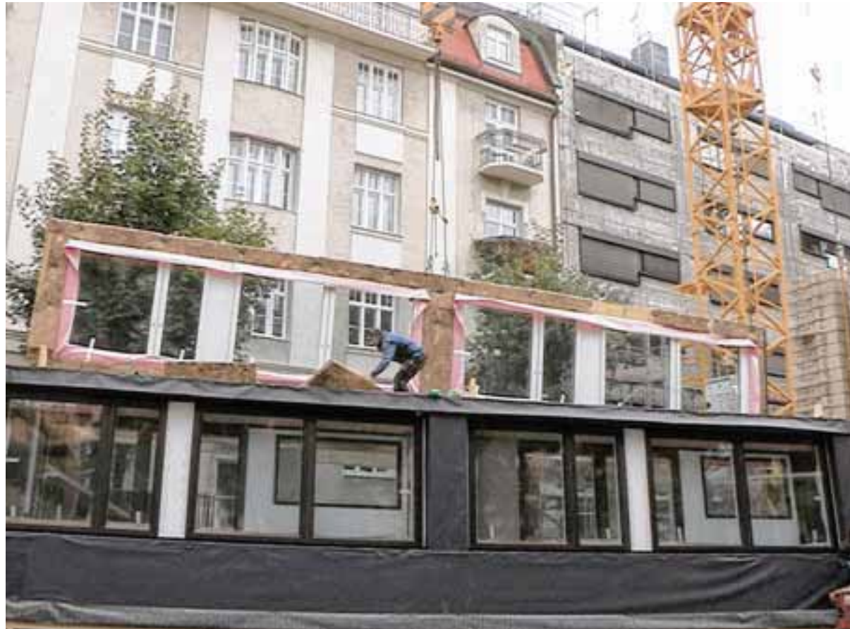
Inklusive Fenster und Dämmung wurden die circa drei mal 13 Meter großen Elemente von der Firma Holzbau Ambros auf die Baustelle geliefert.
