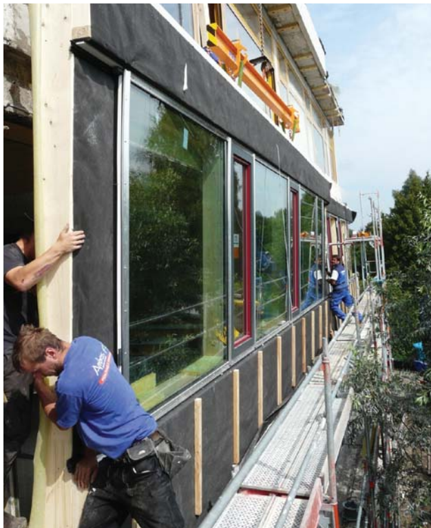
Das Ambros-Team bei der Montage der vorgefertigten Fassadenelemente. Sogar die Fenster wurden im Werk schon eingebaut.
