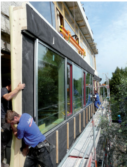
Das Ambros-Team bei der Montage der vorgefertigten Fassadenelemente – sogar die Fenster wurden bereits im Werk eingebaut (Foto: Ambros)
