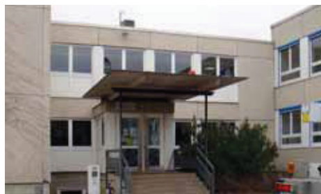
Die alte Fassade aus Waschbetonplatten musste ausgetauscht werden. Die Fenster wurden aber wieder verwendet
